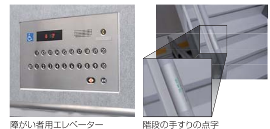
障がい者用エレベーター
