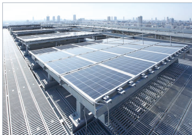
本社屋上に設置したソーラー発電設備 (2012年度 発電量実績 13,614kWh)
