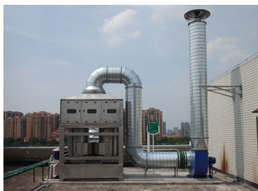
新たに設置された VOC 水処理装置
