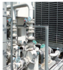
▲冷却水循環ポンプ用モーター
